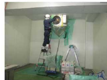
工場中央部に位置する食材倉庫に設置のユニットクーラーを洗浄、電力消費を1ヶ月間連続して計測しました
